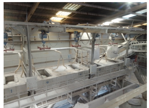
Figura 4. Vista general tolvas de carga. Fuente: Estudio de campo.
